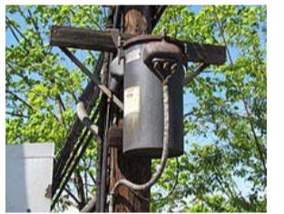
1930年代に製造された電柱上の変圧器 PCB使用機器であることを示すシールが貼られている (ウイキペディア掲載)
