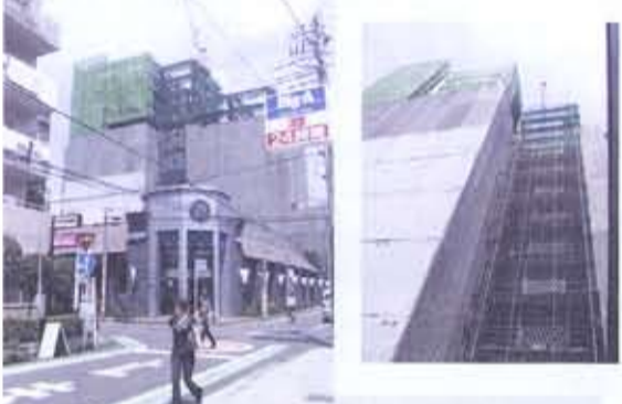
右写真 志木市本町5丁目の高層マンション現場 左写真 その南側の建物は現在平屋だが、高層ビルに立て替えられると、日照は失われる恐れが大きい
